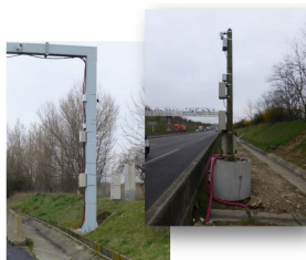
Fig. (7) - Les balises Bluetooth/Wifi installées sur portique (à gauche) et mât temporaire (à droite)
